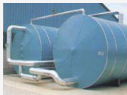
Пример использования буферных аккумуляторов тепла в тепличном хозяйстве
